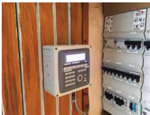
Foto 2: En god varmestyring er nødvendig for at optimere driften af et varmeanlæg
