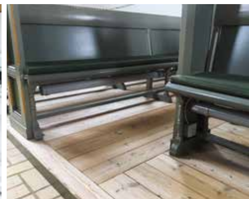
Foto 3: Varmeovne under bænkesæderne giver god komfort og optimal udnyttelse af varmen
