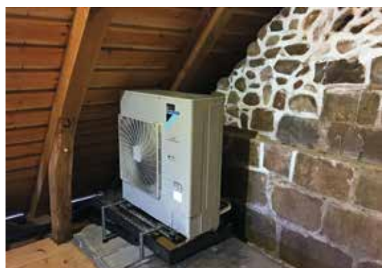
Foto 4: Køleaggregatet til en luft-luft varmepumpe placeret i tagrummet. Kondensvandet opsamlet af en stålbakke og ledes til afløb
